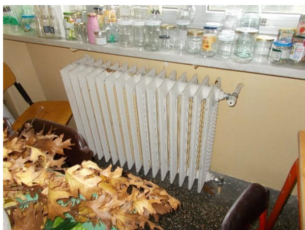
Figura 4.6 – Particolare dei radiatori
