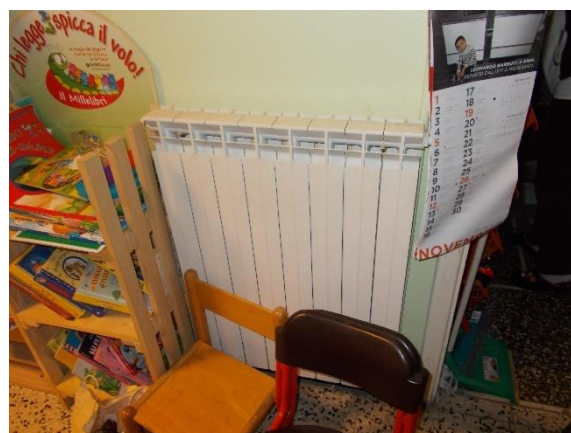
Figura 4.7 - Particolare dei radiatori
