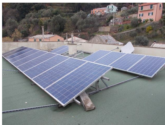
Figura 4.11 - Vista dell'impianto fotovoltaico
